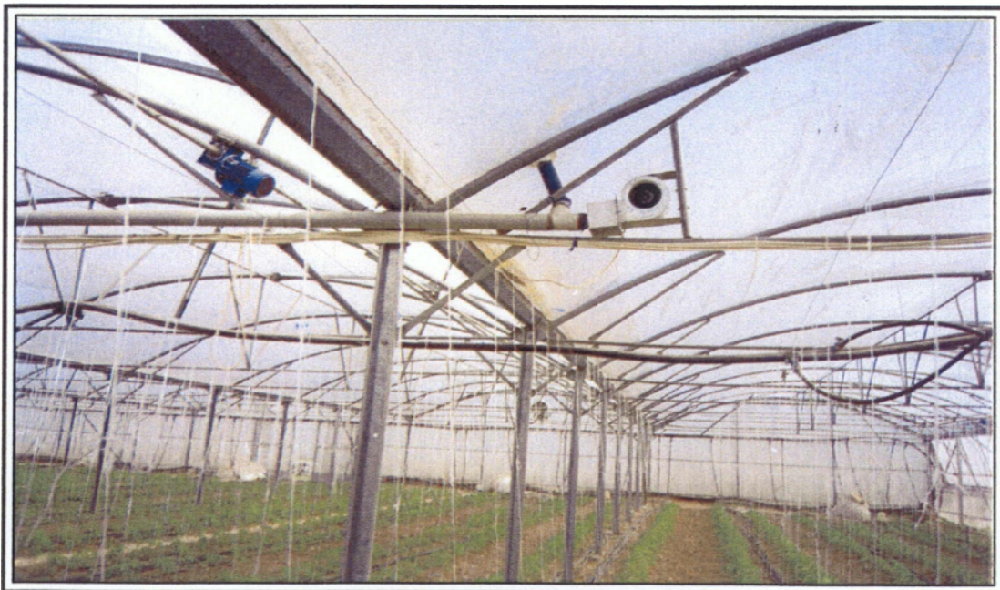
Εικ. 14. Ανοίγμα εξαερισμού οροφής. Βλέπουμε και τον μηχανισμό φουσκώματος του πλαστικού.
