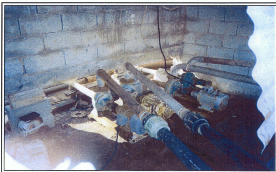
Εικ. 18. Τμήμα μεταφοράς γεωθερμικού ρευστού.
