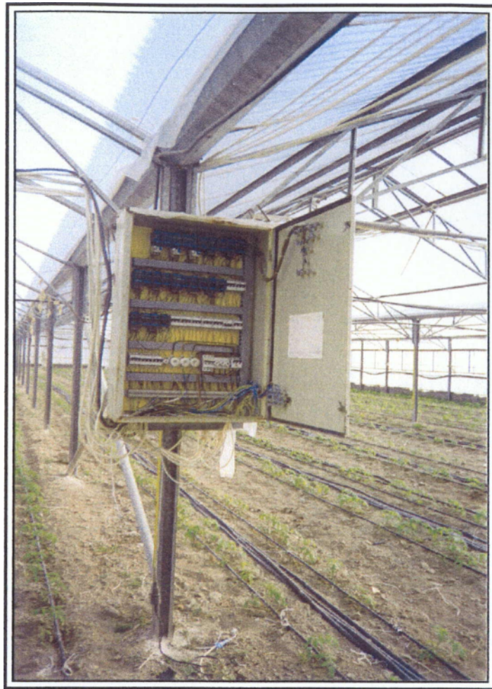
Εικ. 13. Πίνακας αυτοματισμών.
