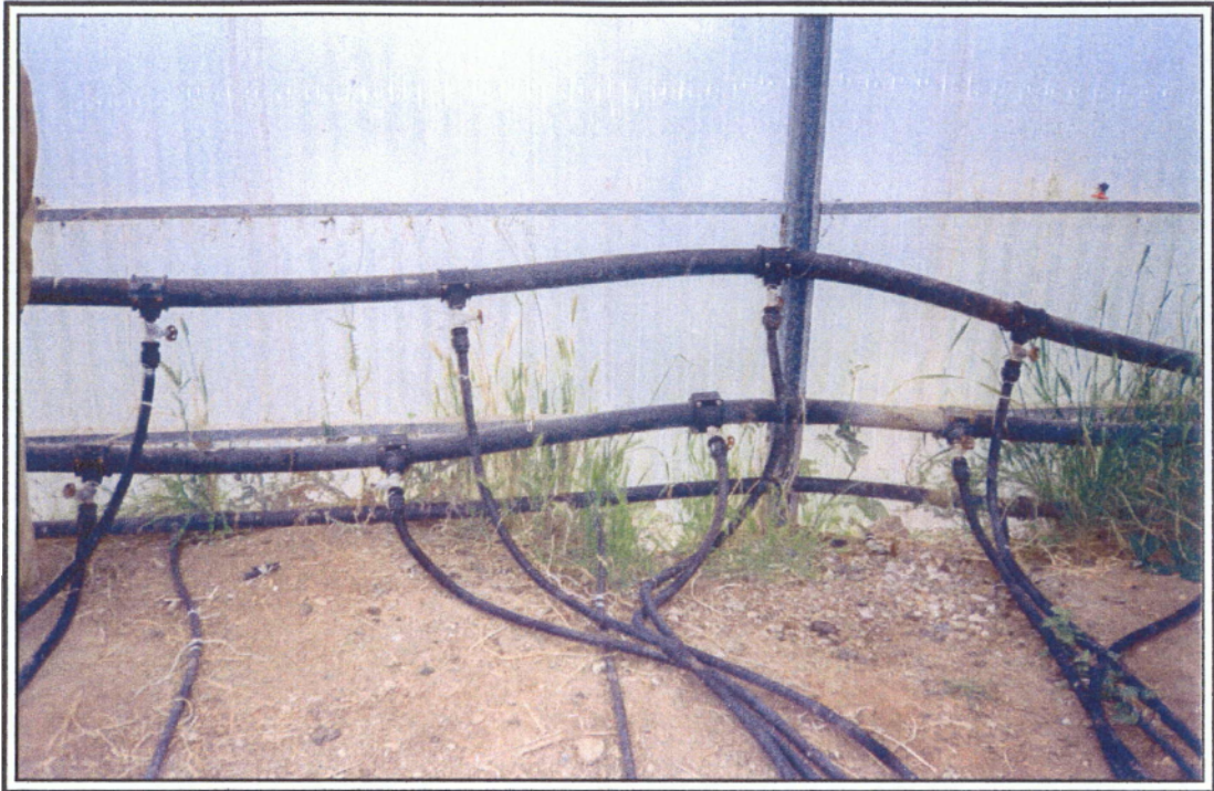
Εικ. 27. Κεντρικοί σωλήνες παροχής γεωθερμικού ρευστού (εισαγωγής-εξαγωγής). Ο πάνω σωλήνας χρησιμοποιείται για την στάγδην άρδευση.
