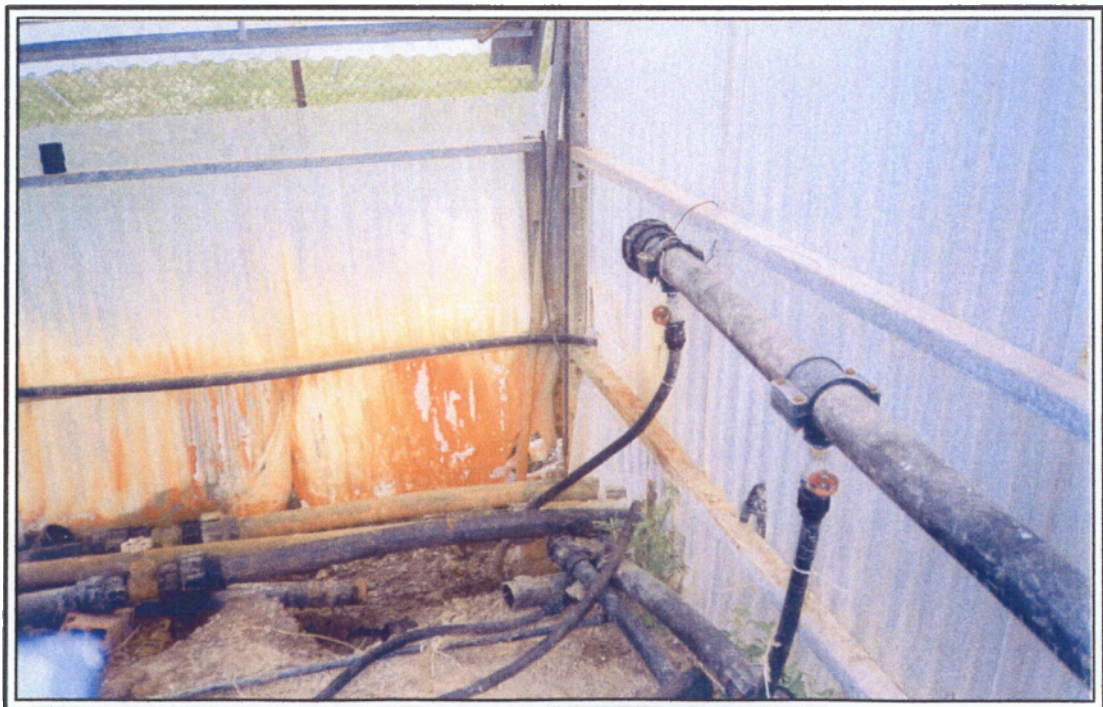
Εικ. 28. Ζημιά στο πλαστικό κάλυμμα κατά την απομάκρυνση του γεωθερμικού ρευστού.
