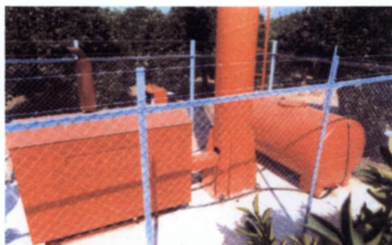
Εικ.3.11. Σιδερένιο πλαίσιο(καπό) του κινητήρα του πετρελαιοκίνητου ανεμομείκτη.
