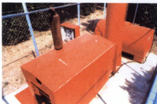
Εικ.3.12. Κινητήρας στο έδαφος και η σύνδεση του με τον πυλώνα του ανεμομείκτη.
