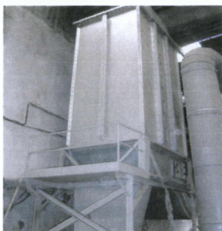
Φωτ.17:Σύστημα αποκατάστασης υγρασίας
