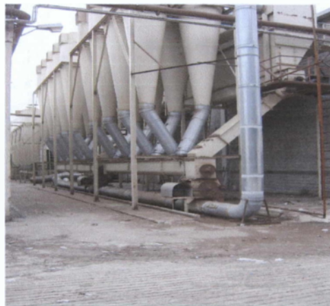
Φωτ.15: Μονάδες ελεγχου τροφοδοσίας
