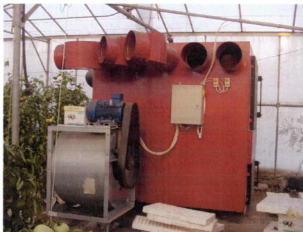
Εικόνα 2. Επιδαπέδιο αερόθερμο σε ένα από τα θερμοκήπια.
