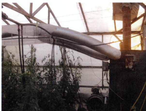
Εικόνα 3. Επιδαπέδιο αερόθερμο στο οποίο φαίνονται προσαρμοσμένοι οι σωλήνες πολυαιθυλενίου μέσω των οποίων μεταφέρεται ο ζεστός αέρας στο χώρο του θερμοκηπίου.
