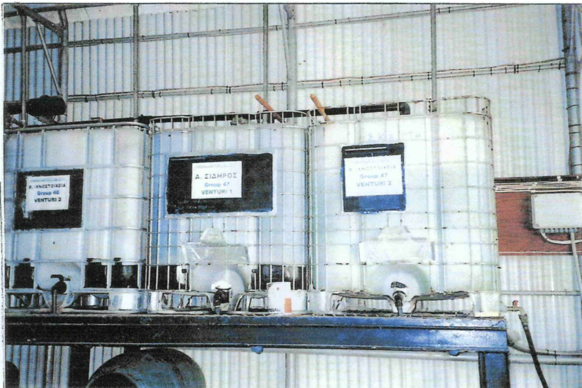
Εικόνα 10: Δεξαμενές λιπασμάτων (φαίνονται οι κάνουλες)
