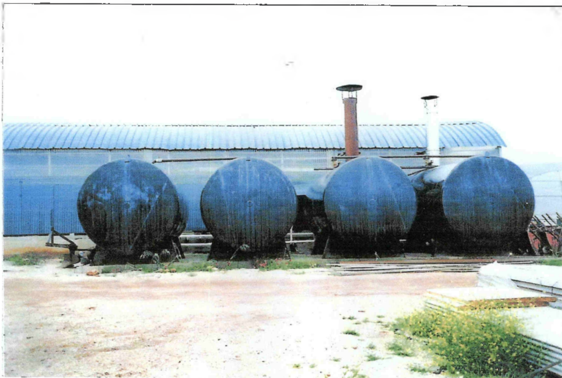
Εικόνα 6: Κτίριο θέρμανσης – Δεξαμενές καυσίμου
