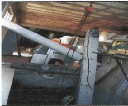
Εικ.2.22 Δεξαμενές ανοξείδωτου χάλυβα
