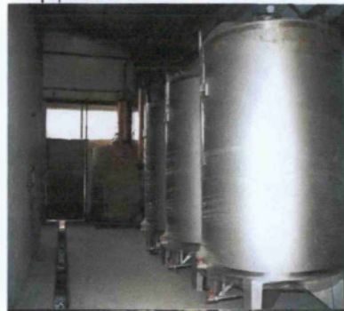
Εικ.2.26 Αποστακτήριο(λέβητας και δεξαμενές αποθήκευσης)
