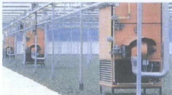
εικ. 3.7 θέρμανση θερμοκηπίου με αερόθερμα
