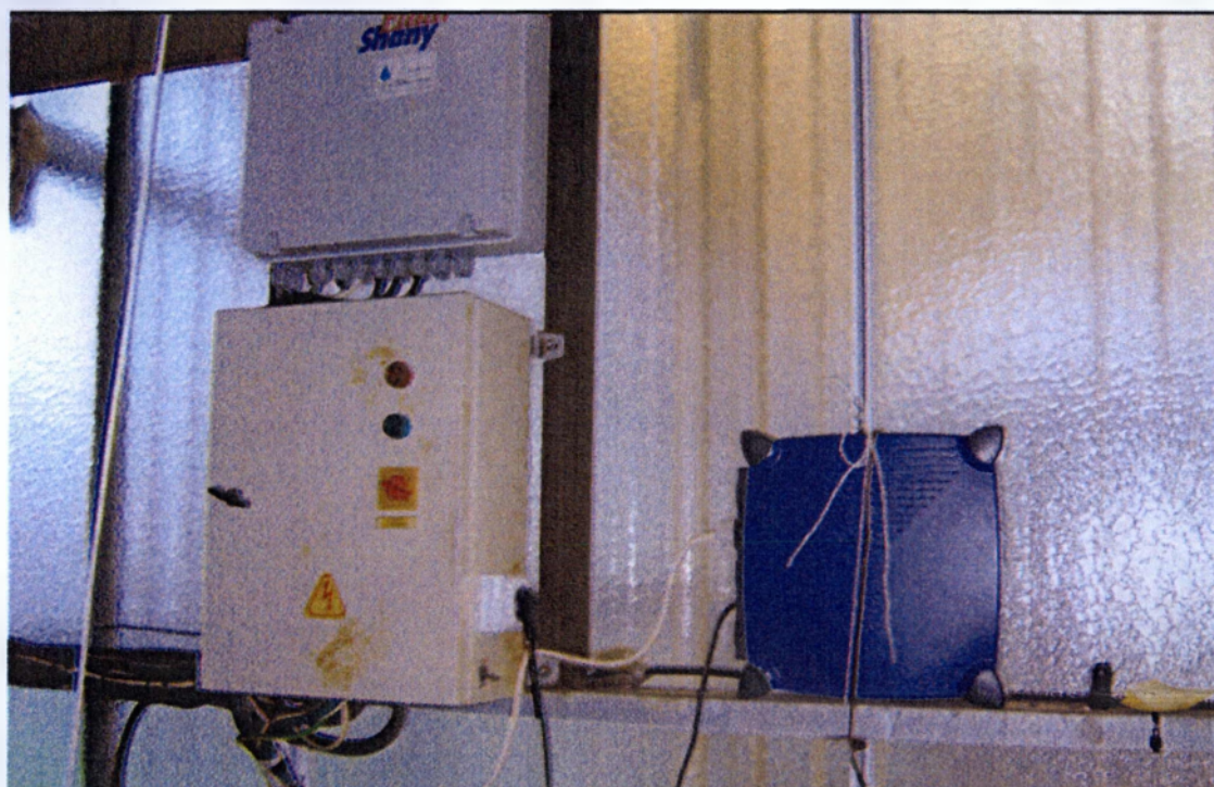
Εικόνα 17. Διακρίνουμε τον κεντρικό πίνακα ελέγχου ρεύματος του θερμοκηπίου, τον κεντρικό επεξεργαστή του computer και τον χρονοδιακόπτη στάσεων άρδευσης της καλλιέργειας.
