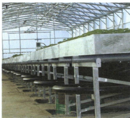
Εικ. 3.1. Σωλήνες κυκλοφορίας ζεστού νερού για θέρμανση κάτω από τα τραπέζια καλλιέργειας (Γεωργία – Κτηνοτροφία, 1999).
