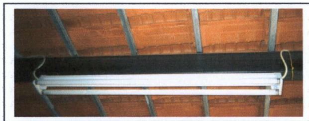
Εικ.4.2ε λαμπτήρες φθορίου .
