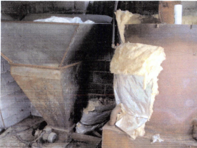
Εικ.4.34 Μέρος θέρμανσης και στα δεξιά υπάρχει ο λέβητας που είναι επενδυμένος με υαλοβάμβακα.
