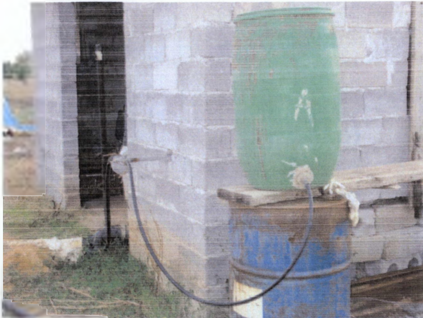
Εικ. 4.37 Δοχείο πλήρωσης του λέβητα με νερό
