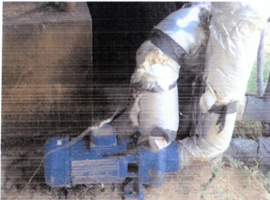
Εικ. 4.36 Ο κυκλοφορητής του συστήματος θέρμανσης
