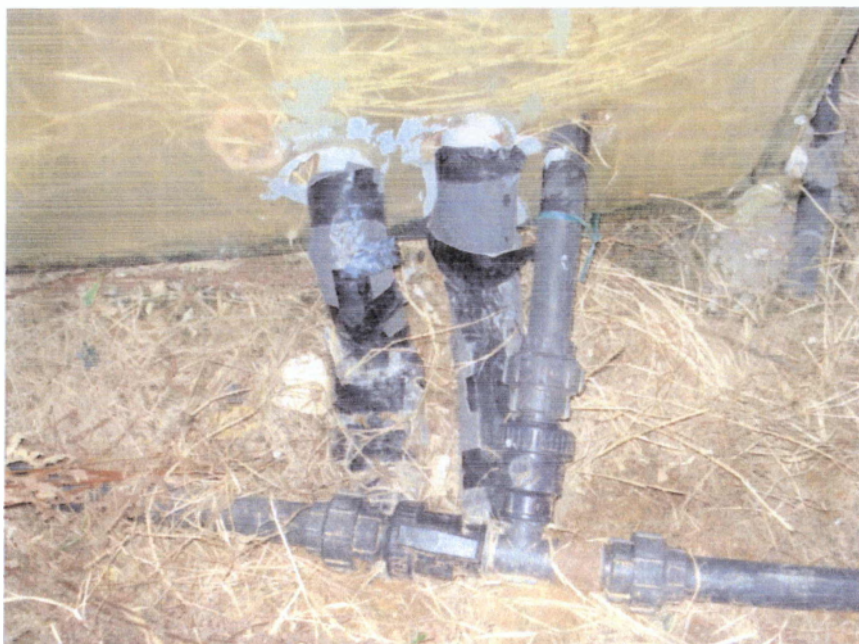
Εικ. 4.20 Οι σωλήνες άρδευσης έξω από το θερμοκήπιο με την βοήθεια των οποίων στο εσωτερικό του θερμοκηπίου συνδέεται ο μαύρος πλαστικός σωλήνας άρδευσης.
