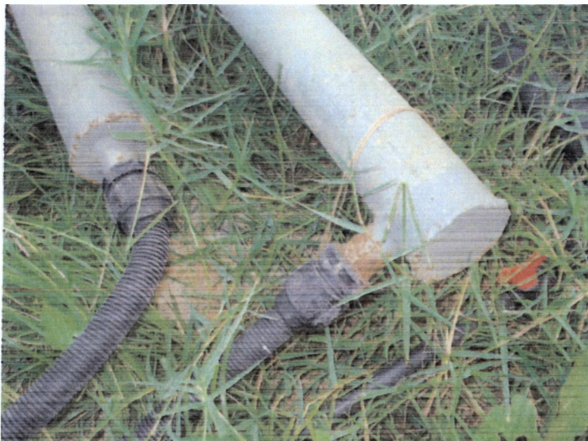
Εικ. 4.38 Οι σωλήνες θέρμανσης πως είναι συνδεδεμένες στο τέλος των σωληνώσεων.
