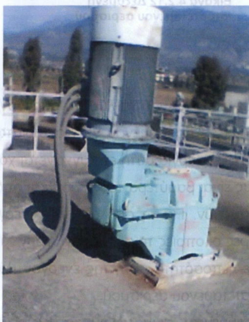
Εικόνα 4.2.9 Κινητήρας του μηχανισμού παρατεταμένου αερισμού
