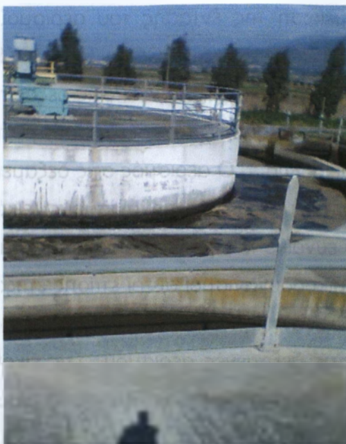
Εικόνα 4.2.11 Δεξαμενή παρατεταμένου αερισμού
