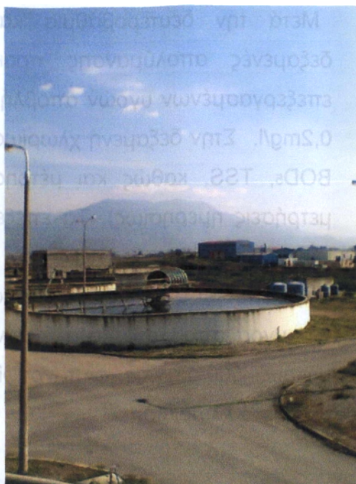
Εικόνα 4.2.14 Δεξαμενή δευτεροβάθμιας καθίζησης
