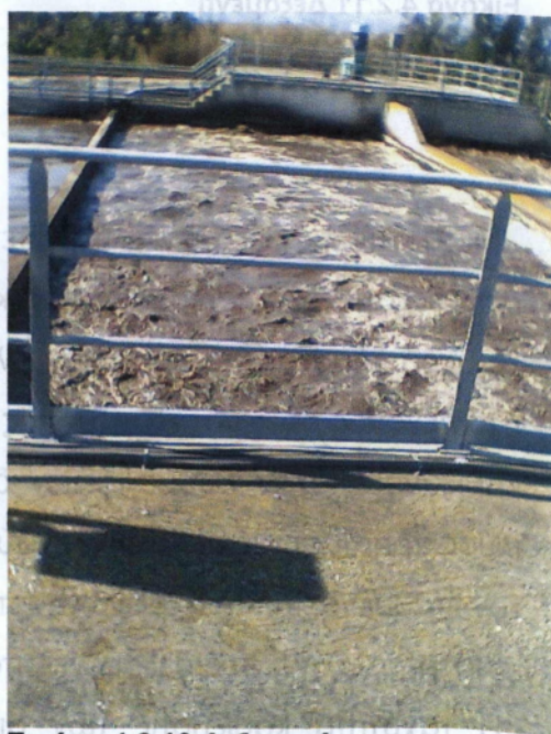
Εικόνα 4.2.10 Δεξαμενή παρατεταμένου αερισμού
