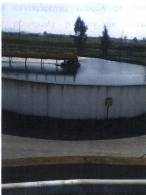
Εικόνα 4.2.13 Δεξαμενή δευτεροβάθμιας καθίζησης
