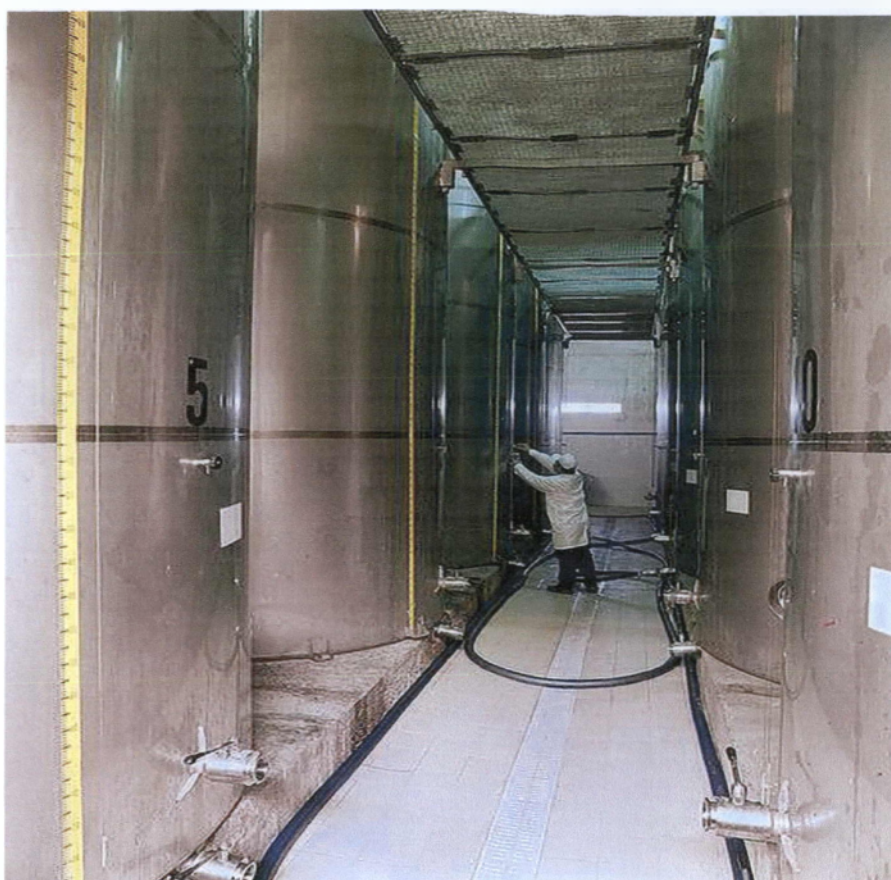
Εικόνα 56: Χώρος δεξαμενών ελαιολάδου
