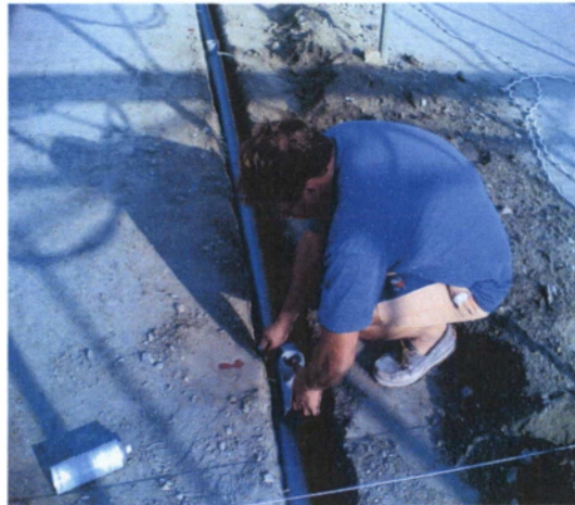
Εικόνα 20: Αγωγός δικτύου άρδευσης
