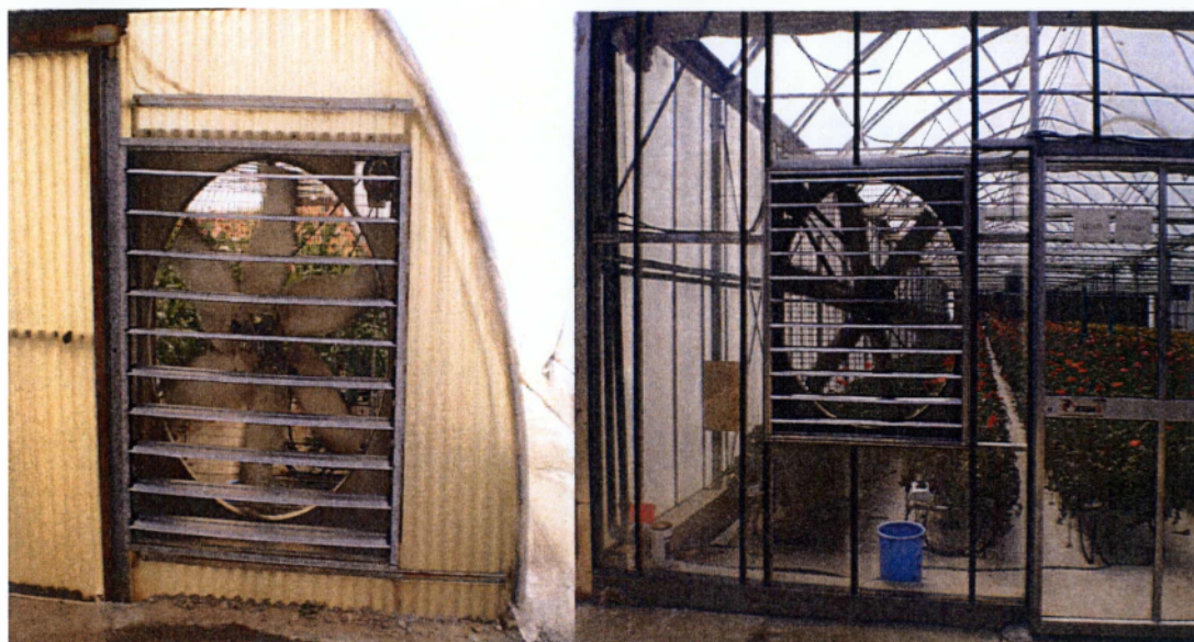
Εξαεριστήρες θερμοκηπίου ( ΓΕΩΘΕΡΜ Α.Ε )
