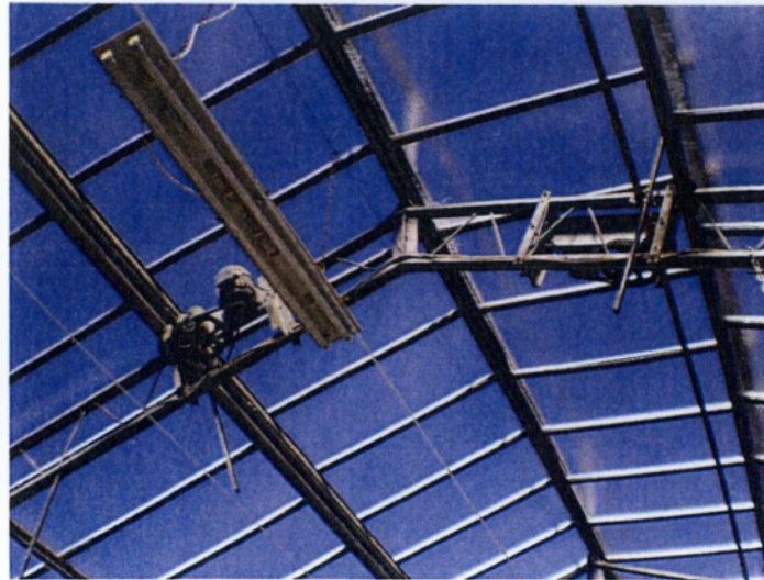
Μηχανισμός ανοίγματος παραθύρων οροφής για φυσικό αερισμό (ΓΕΩΘΕΡΜ Α.Ε )
