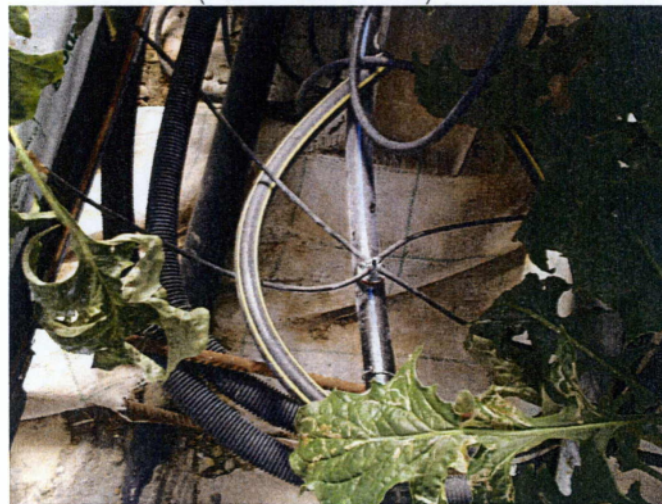
Σύστημα τροφοδοσίας (ΓΕΩΘΕΡΜ Α.Ε)
