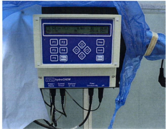
Εικόνα 2: Κεφαλή συστήματος επίπλευσης
