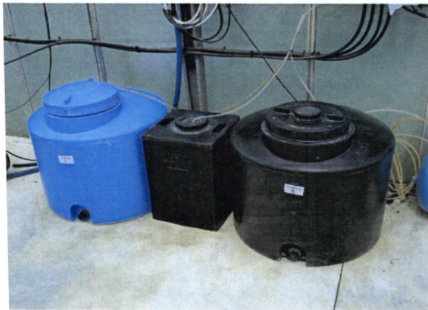
Εικόνα 2.5: Δεξαμενές πυκνών διαλυμάτων
