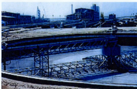
Εικ.104 Ταινία μεταφοράς υγρών αποβλήτων για ανακύκλωση
