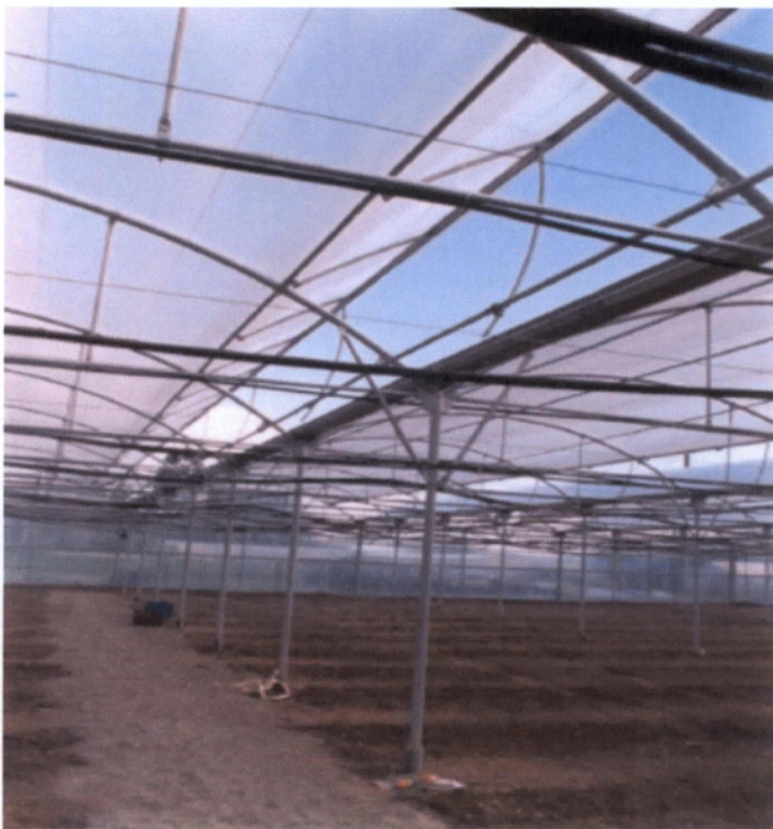
Εικόνα 8. Φυσικός Αερισμός, Παράθυρα οροφής
