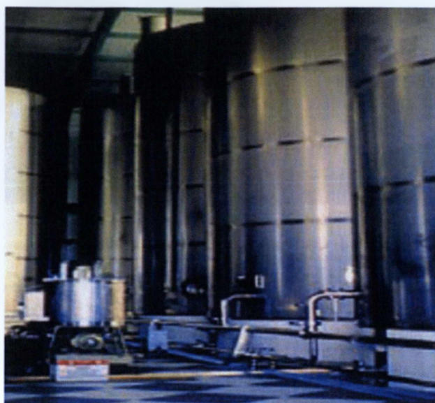
Εικόνα 23.- Δεξαμενές ελαιολάδου σε αποθήκες (πηγή: http://www.tdcolive.net )
