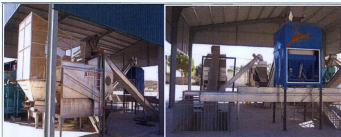
Εικόνα 3.- Εγκατάσταση για τον καθαρισμό και το ζύγισμα του καρπού (πηγή: http://www.tdcolive.net )
