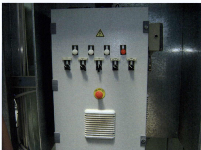
Εικόνα 3: Ηλεκτρικός πίνακας, έλεγχου λειτουργίας floating, υδρονέφωσης και ανεμιστήρων.
