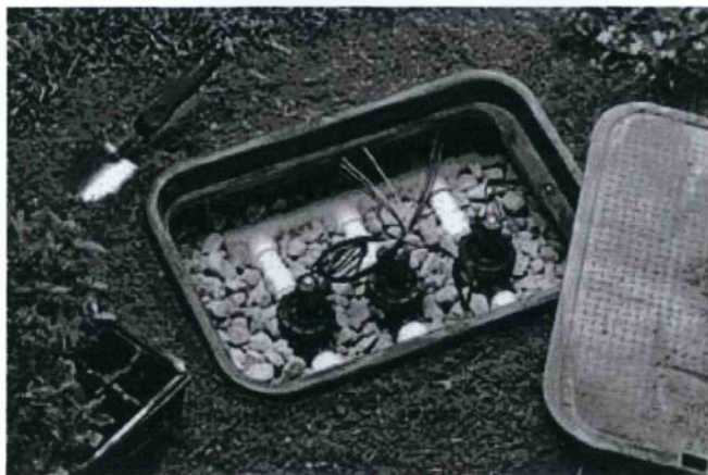
Εικ.26 Φρεάτιο με ηλεκτροβάνες (πηγή Διαδίκτυο)
