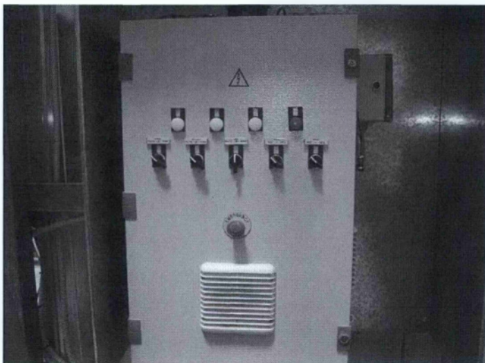
Εικόνα 3: Ηλεκτρικός πίνακας, ελέγχου λειτουργίας floating, υδρονέφωσης και ανεμιστήρων.
