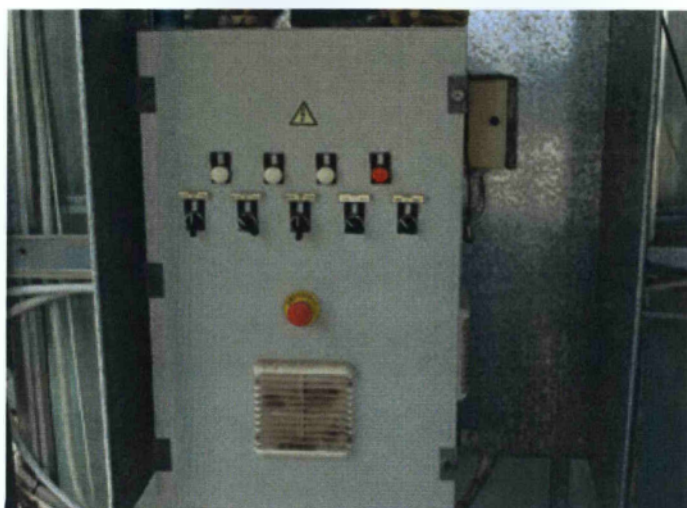
Εικόνα 13 : ηλεκτρικός πίνακας ελέγχου υδροπονικού συστήματος, υδρονέφωσης και ανεμιστήρων.
