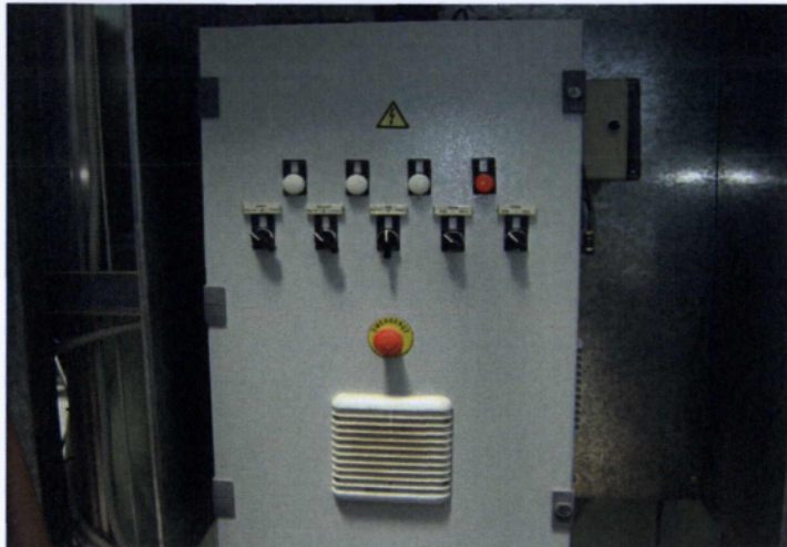
Εικόνα 4: Ηλεκτρικός πίνακας, ελέγχου λειτουργίας floating, υδρονέφωσης και ανεμιστήρων.
