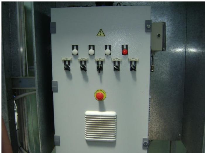
Εικόνα 1.1: Ηλεκτρικός πίνακας ελέγχου της λειτουργίας του συστήματος επιπλεύσεως
