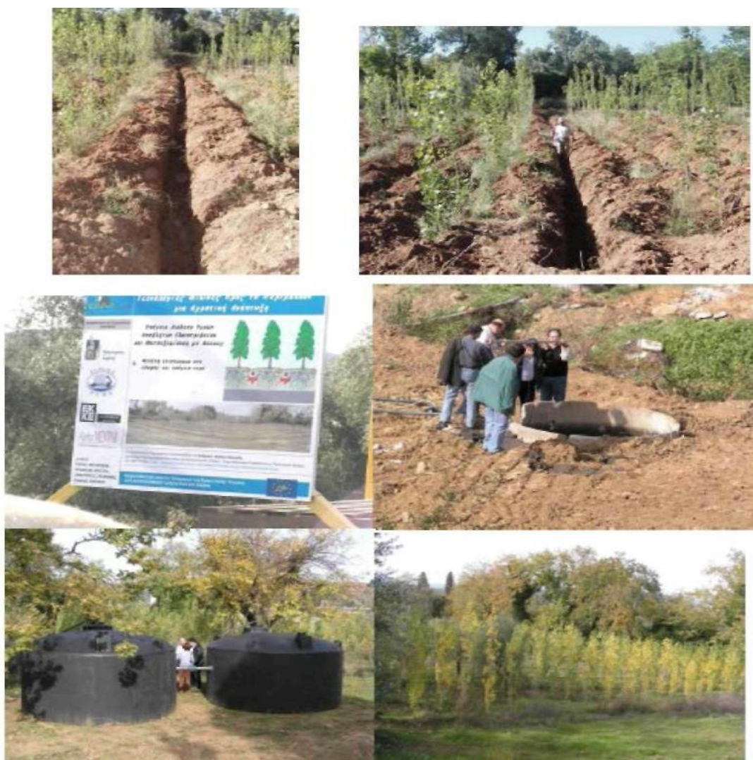
Εικόνα 6.2.4.2 Απεικόνιση τεχνολογίας υπεδάφιας διάθεσης υγρών αποβλήτων ελαιοτριβείου σε συνδυασμό με φυτοεξύγιανση – Ελαιοτριβείο Κοκολής (Χάνια-Βασιλάκη) (Καλογεράκης & Νικολαΐδης, 2008)
