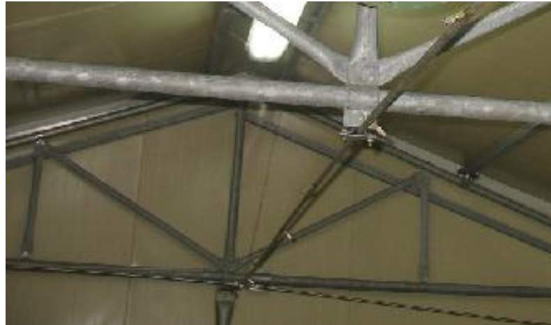
Εικόνα 3.3: Σύστημα fog – διακρίνεται ο μεταλλικός σωλήνας μεταφοράς νερού και τα μεταλλικά ακροφύσια (πηγή: Διαδίκτυο 12).
