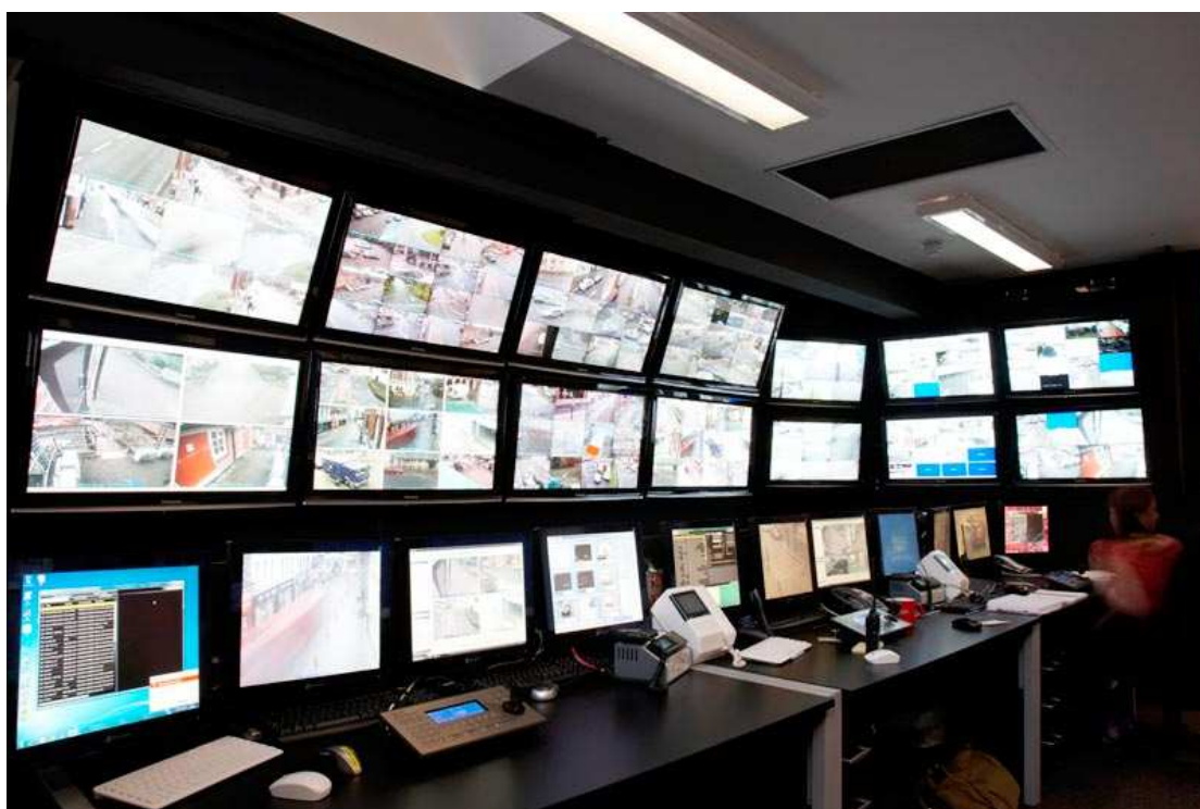
Εικόνα 2.7 – Περιβάλλον φιλοξενίας ενός κέντρου ελέγχου
